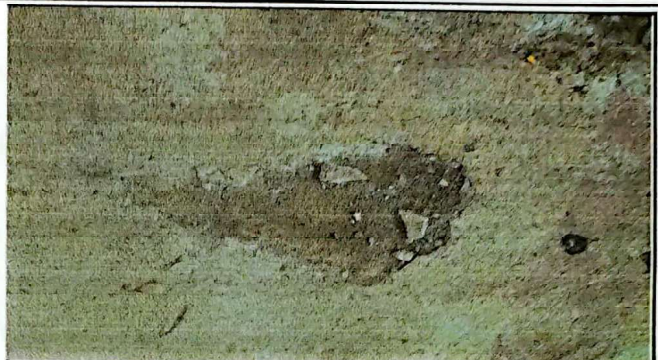
Foto 2: SE MEJORARÁ EL PISO DE LAS AULAS YA QUE SE ENCUENTRAN EN MAL ESTADO.
