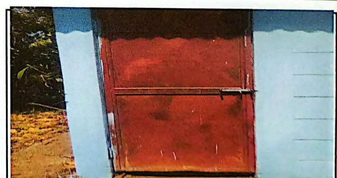
Foto 6: SE MEJORARÁ LAS PUERTAS DE LOS BAÑOS YA QUE ESTAN DETERIORANDO.
