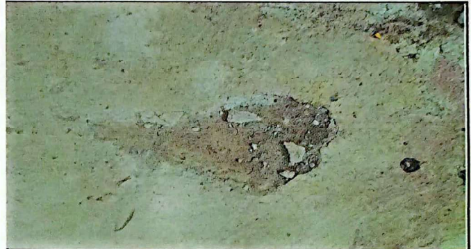
Foto 2: SE MEJORARÁ EL PISO DE LAS AULAS YA QUE SE ENCUENTRAN EN MAL ESTADO.
