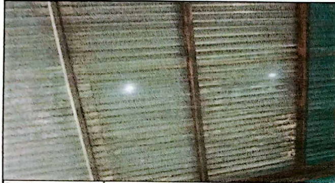
Foto 1: SE REALIZARÁ CAMBIO DE ESTRUCTURA DE TECHO (CAMBIO DE LAMINAS Y COSTANERAS)
